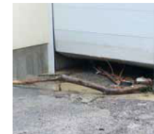
Altstätten, Hochwasser 2014 Eingedrücktes Tiefgarageneinfahrt
