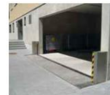
Altstätten Klappschott zum Schutz der Tiefgarageneinfahrt
