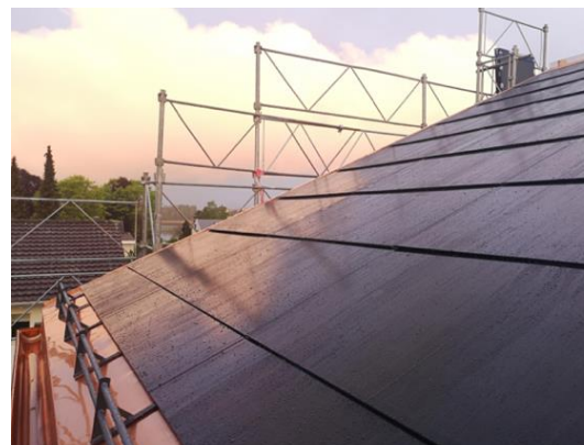
Detailaufnahme Solaranlage Foto: Sunage SA
