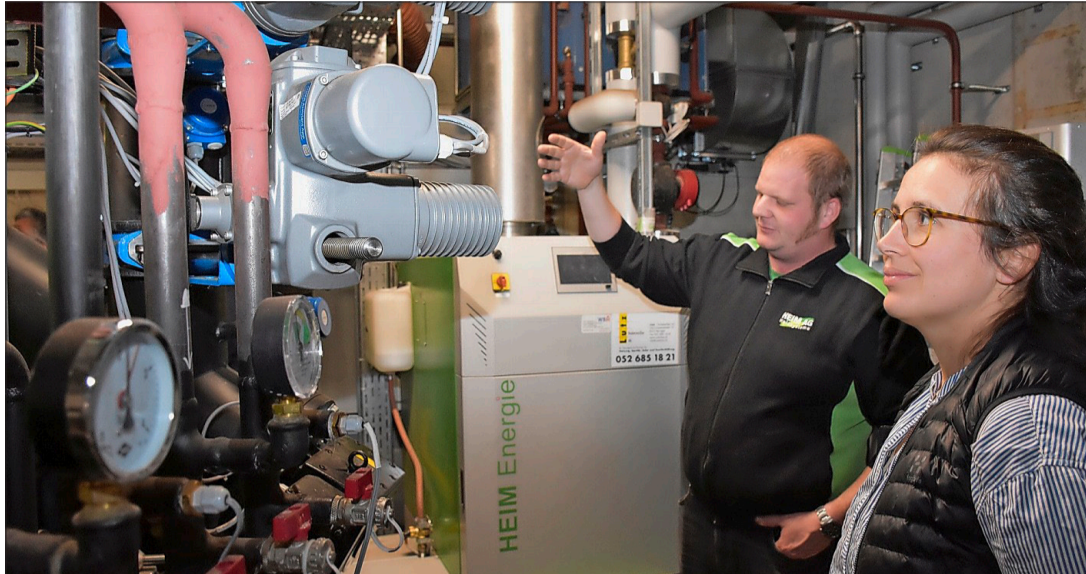
Der Siblinger Heizungsbauer Lukas Hallauer von der Heim AG erklärte das kleine «Glock» Blockheizkraftwerk im neuen Randenhaus. (Bilder: Thomas Güntert)
